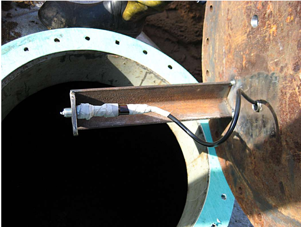
Foto 5 Tändstift inne i cistern
