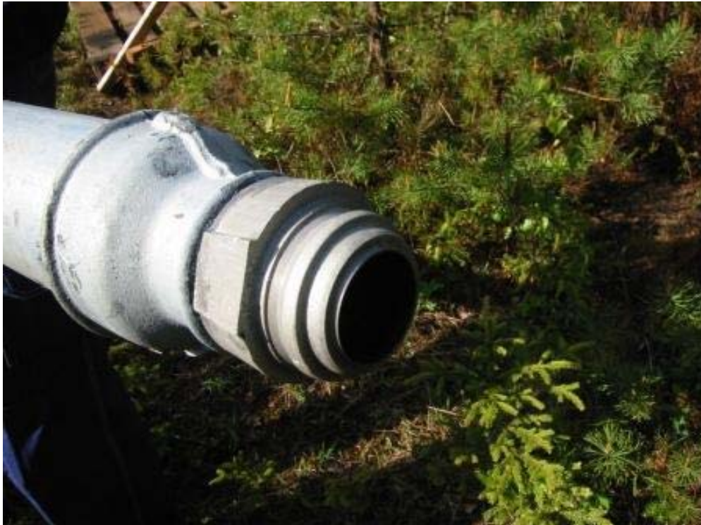
Foto 13 P/V-ventil på avluftningsledning efter försöken. Regnskyddet blåste av vid antändningsförsöket.
