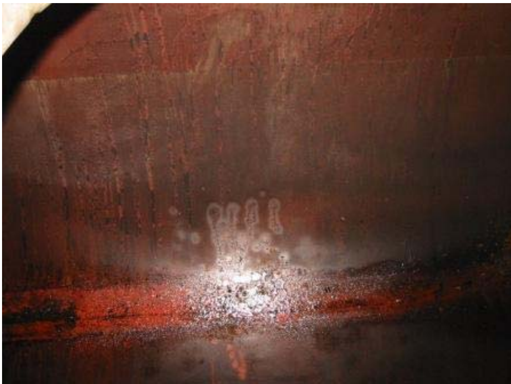
Foto 14 Inne i cisternen efter upptagning ur mark (07-05-07). Endast lite fukt av bränsle återstod på cisternbotten.
